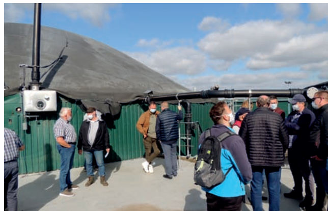
Rysunek 10. Biogazownia w OHZ "Gajewo" (woj. pomorskie)
