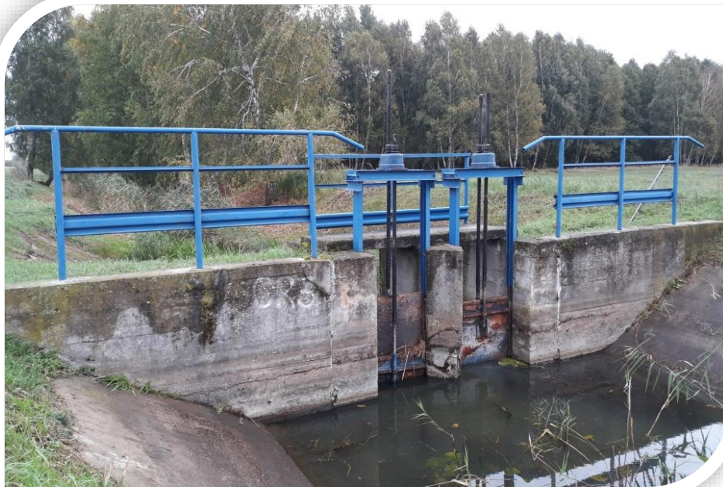
Jaz piętrzący współpracujący z systemem nawodnień podsiąkowych – gmina Szubin Fot. B. Kierasiński
