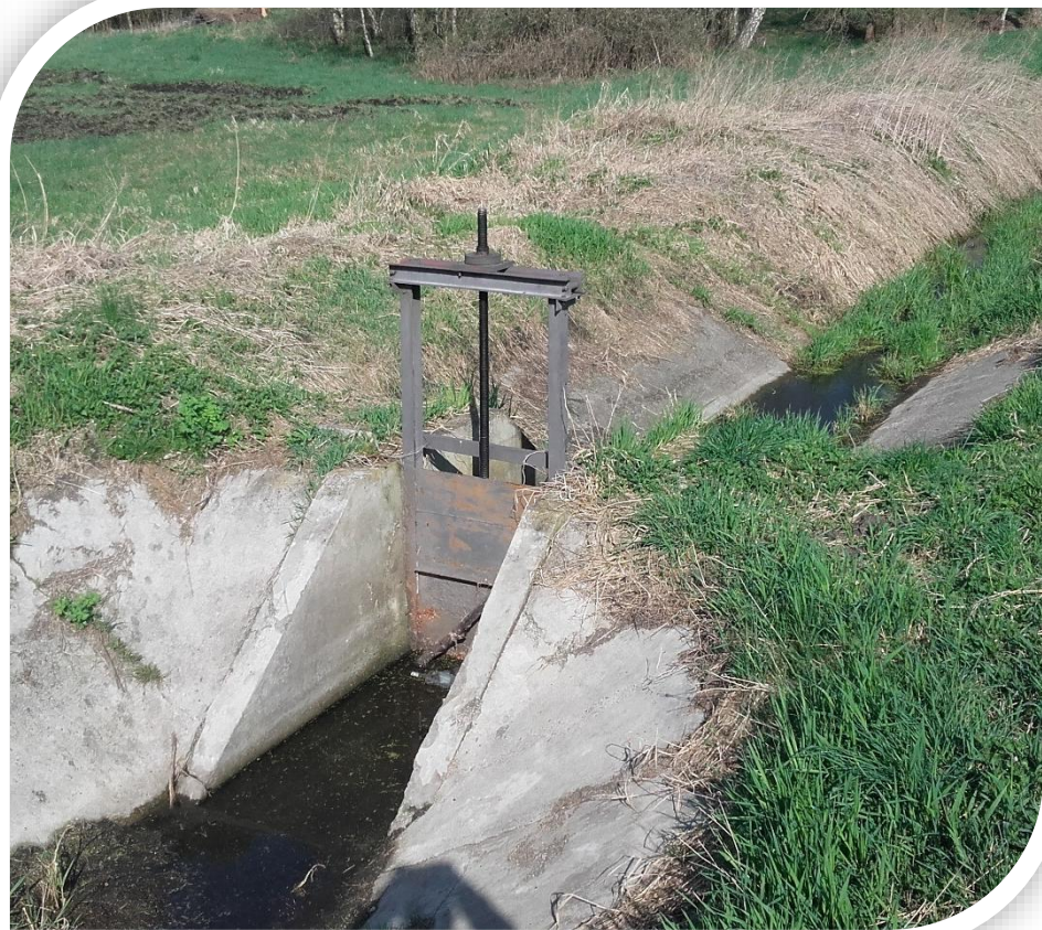
Zastawka ze stalową zasuwą na rowie melioracyjnym w m. Kołaczkowo, Fot. B. Kierasiński
