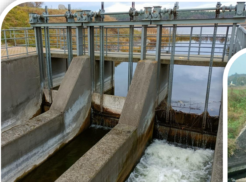
Jaz na wylocie z Jeziora Rajgrodzkiego z zasuwami stalowymi (podwyższenie piętrzenia płytami betonowymi), Fot. W. Warowna
