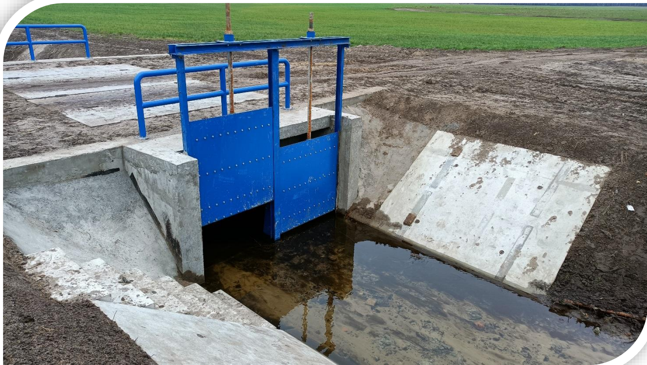
Przepustozastawka zasuwowa pod drogą polną na rzece Gulczanka, Fot. W. Warowna
