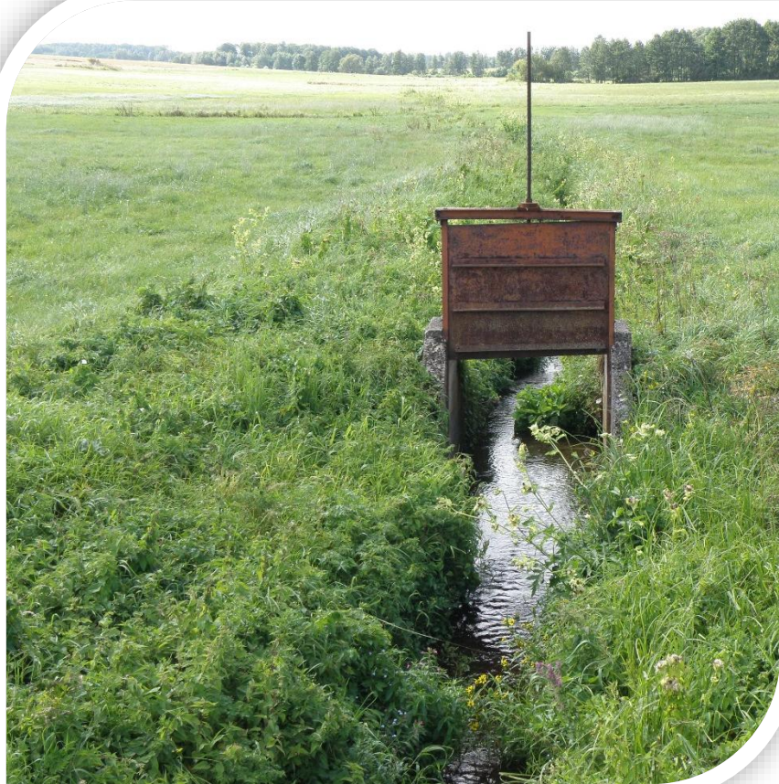
Nieużywana zastawka ze stalową zasuwą w m. Sławiec, Fot. Z. Kowalewski
