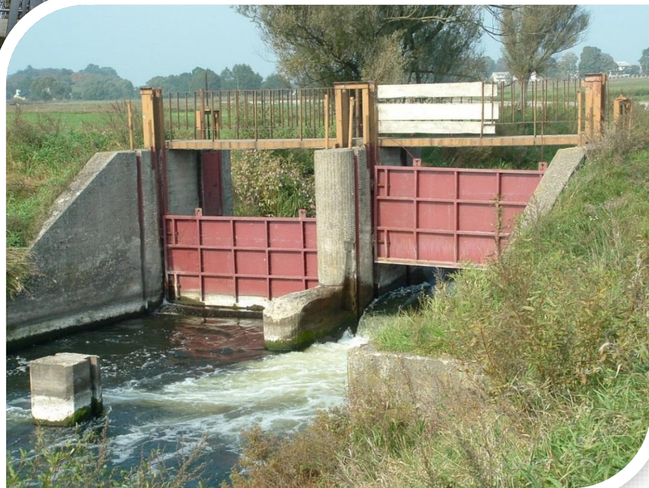
Jaz zasuwowy z podwieszonymi nie działającymi zasuwami, Fot. W. Mioduszewski
