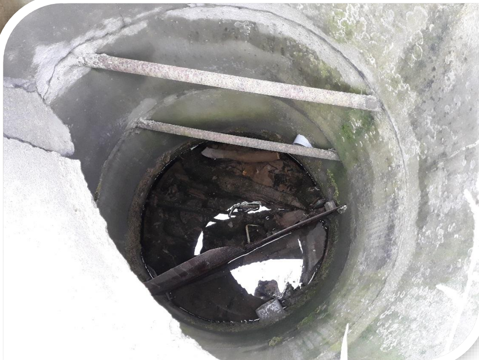
Stalowy przelew w dnie studzienki drenarskiej opóźniający odpływ wody - okolice Ostrowa Szlacheckiego, Fot. B. Kierasiński
