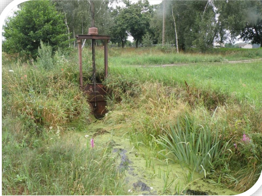
Zastawka ze stalową zasuwą na rowie melioracyjnym – gmina Szubin Fot. B. Kierasiński
