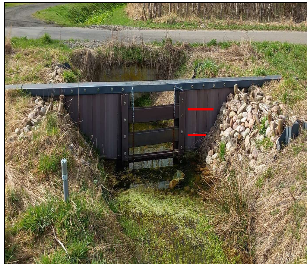
Ażurowe zamknięcie szandorowe na zastawce
